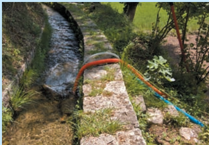
PRISE D'EAU EN AVAL DU CANAL
