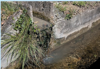
ÉCOULEMENT BLANCHÂTRE TYPIQUE DU GYPSE
